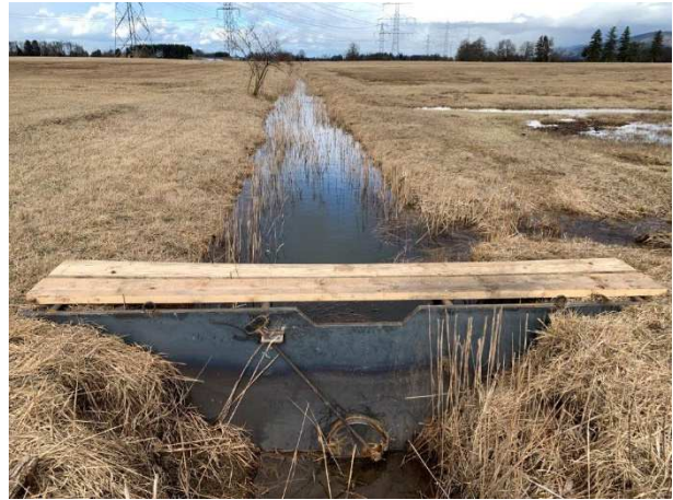
Der Wasserrückhalt ist gleichsam für Streuwiesen als auch Wiesenbrüter von großer Bedeutung. Die beiden Schweizer Ortsgemeinden Widnau und Schmitter haben dem Einsatz einer neuen Grabensperre im Natura 2000-Gebiet Gsieg zugestimmt und zudem die Hälfte der Kosten getragen.
