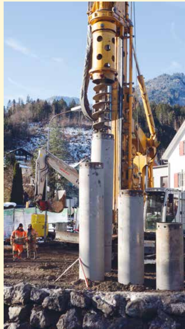
Dieser Monsterbohrer bohrt die Löcher für die Stützpfeiler der neuen Brücke, durch welche auch die Hochwassersicherheit verbessert werden kann.
