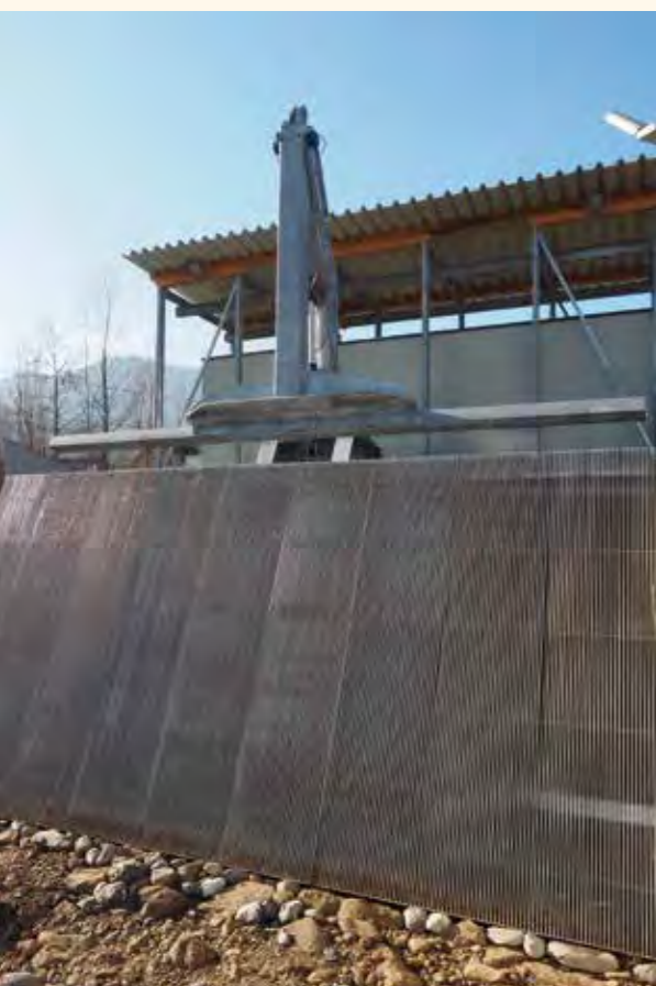
Ein automatischer Rechen beugt nun Verstopfungen an der Pumpe am Gießenbach vor.
